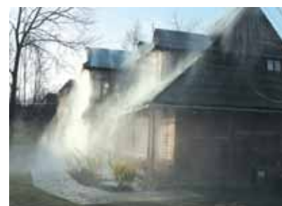
System przeciwpożarowy w zabytkowej willi „Atma” w Zakopanem
